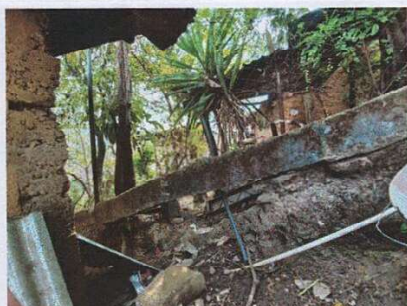
Foto 3: Refuerzo y reparación a muro perimetral en mal estado.
